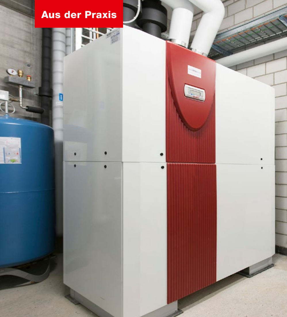
Die gigantische Wärmepumpe SMS-XP-75-TU wie auch die gesamte Wärmeverteilung in der Talstation Churwalden wurden von Tobler geliefert.
