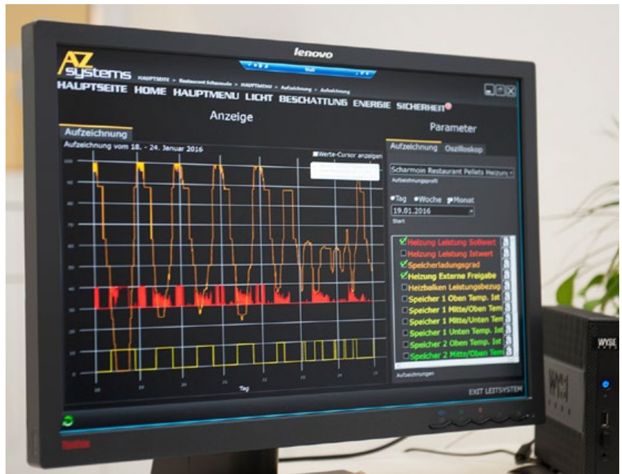
Das topmoderne Gebäudeleitsystem ist in allen Betriebsgebäuden der Schneesportregion Lenzerheide integriert.
