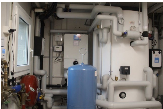
Kompakte neue Anlage im Heizkeller.
