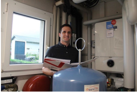
Michael Meichtry ist zufrieden mit seiner neuen Bosch-Wärmepumpe, die aus einer Inneneinheit (rechts) und einer Ausseneinheit (links, hinter dem Fenster) besteht.
