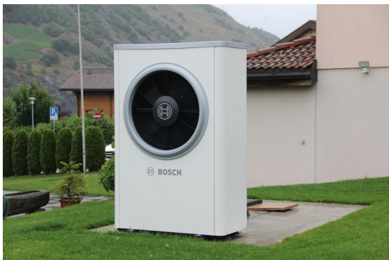
Noch ohne Spielhaus-«Anbau»: Formschöne Ausseneinheit vor dem Haus.
